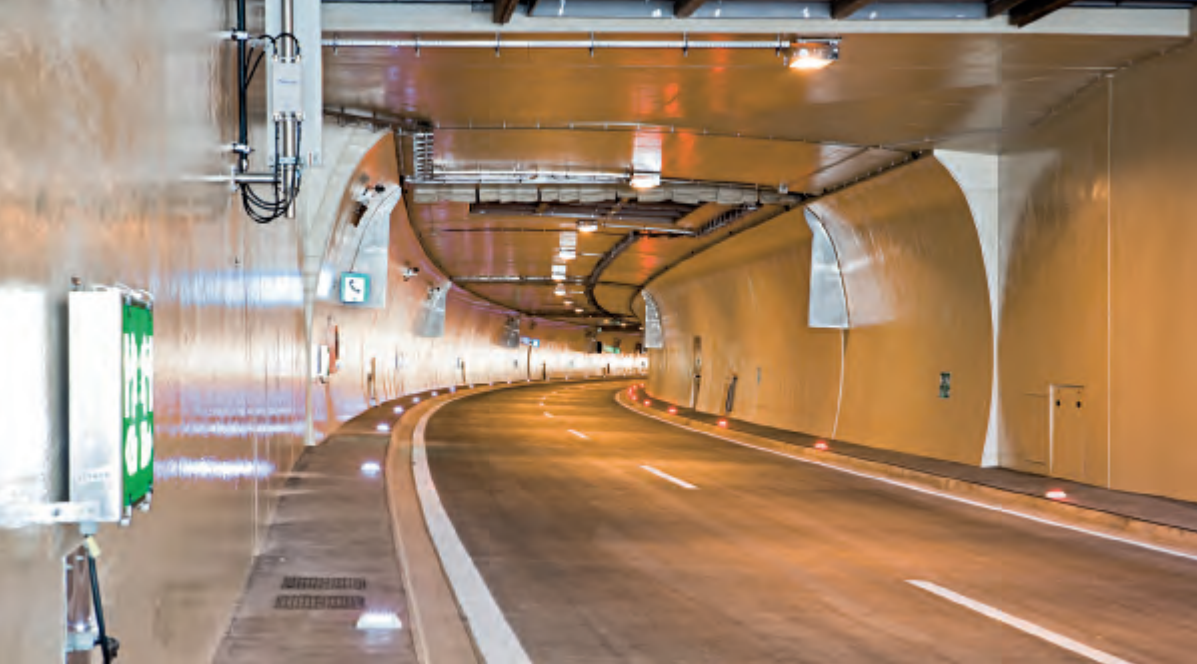
Roppener Tunnel, Tirol: Elektro- und Anlagentechnik von der IGO-Ortner Gruppe
